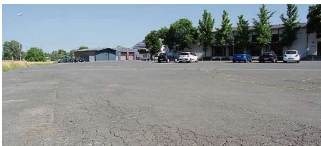
Der Parkplatz an der Volkshalle Ehringhausen sollte schicker werden. Nun macht der Untergrund Probleme.
